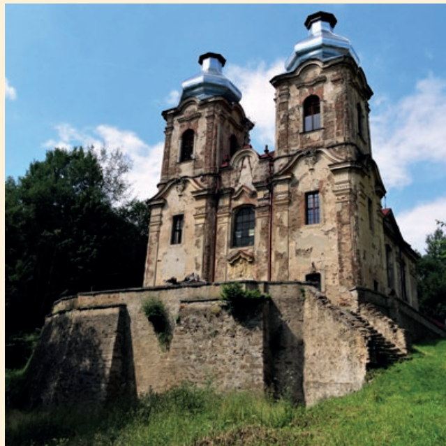
Kostel s provizorně opravenými báními
