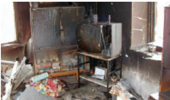
Požár bytu způsobený závadou na televizoru
