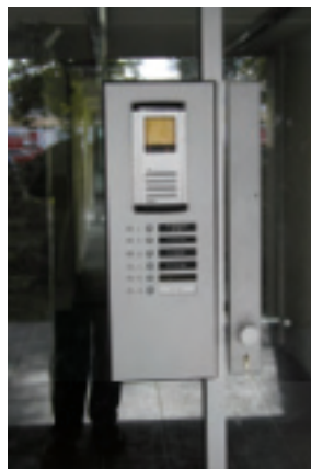
Dorozumívací zařízení u vstupu do domu
