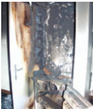
Požár bytu od závady na lednici
