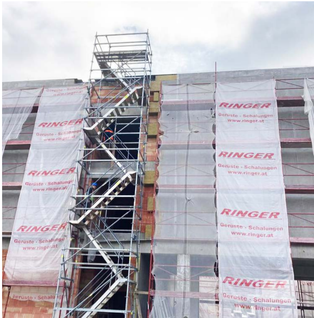
Depozitář Nová budova Krajské knihovny Karlovy Vary by měla být dostavěna v únoru 2021.
