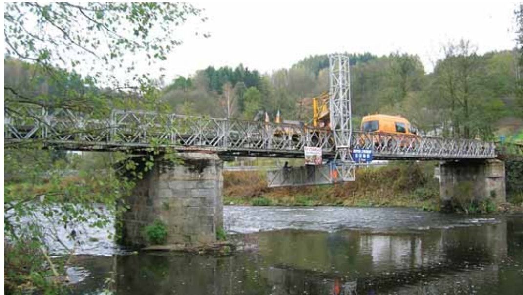
Šemnický most je v havarijním stavu.
