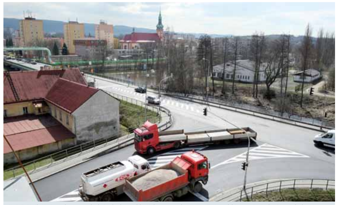
Největší silniční stavby za poslední roky komplikují dopravu v kraji. Značné problémy má především Sokolov.
