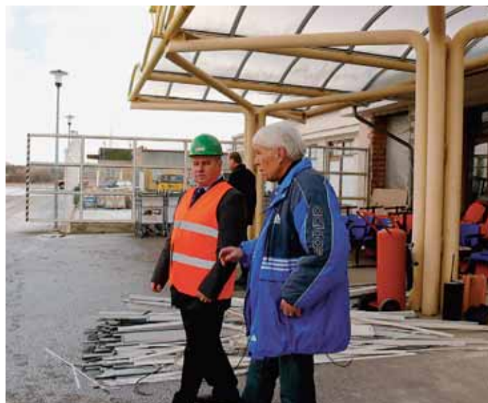
Jednou z priorit Karlovarského kraje je přestavba mezinárodního letiště v Olšovcích Vratech. Hodiny strávené kontrolami postupu prací na nové odstavovací hale počítá Jan Zborník na stovky.
