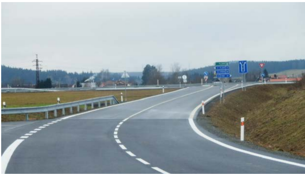
Obchvat Mariánských Lázní. Jedna z největších investičních akcí v oblasti dopravy vyšla na 266,7 milionu korun.
