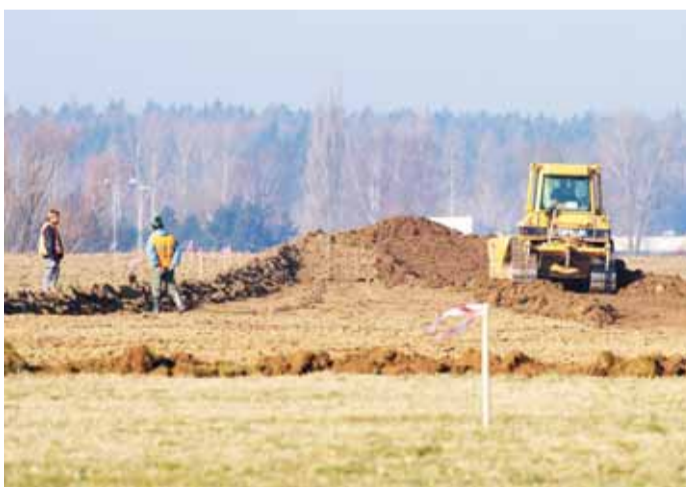
Ve středu 12. března začala na poli nedaleko chebské části Háje výstavba jihovýchodního obchvatu Chebu. Stavba silnice, která propojí Svatý Kříž s rychlostní silnicí R6, potrvá do konce srpna 2015.
