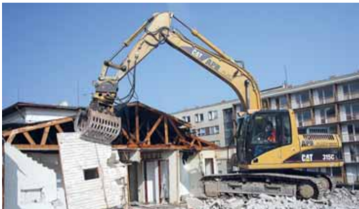
V dubnu 2010 byla demolice překážejících objektů zahájena stavba pavilonu akutní medicíny a centrálního příjmu v karlovarské nemocnici.
