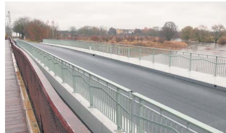
JINDŘICHOV – Rekonstrukce 56,2 metru dlouhého mostu přes Ohří u Jindřichova se prováděla za úplné uzavírky silnice. Peší obcházeli stavbu po souběžném železničním mostě, řidiči vyhlíželi, kdy práce na mostě skončí. Výměna mostního svršku, vybetonování nové betonové desky i výměna zábradlí stály kraj 17,8 milionu korun.
